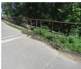
橋面土砂堆積
