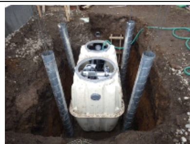
浄化槽 整備状況
