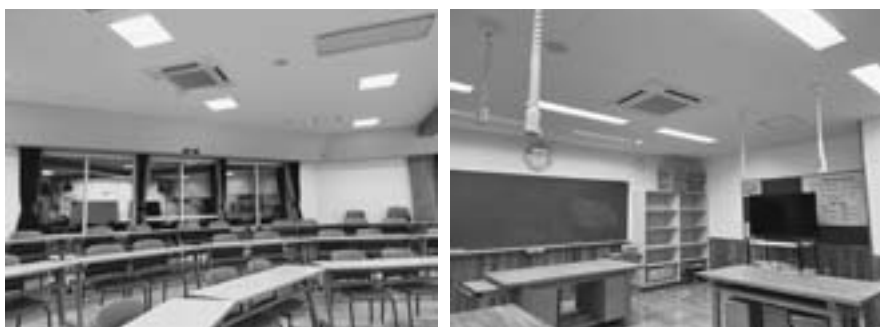
足寄中学校音楽室(左)・技術室(右)のエアコン
