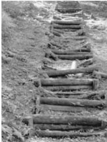
破損した木柱階段
