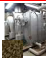
木質バイオマス ボイラー
