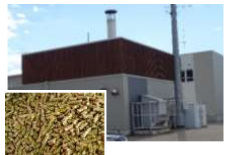
図 3.18 役場木質ペレットボイラー
