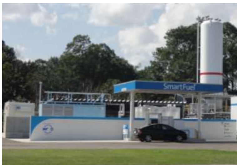
図 6.9 鹿追町水素ステーション
