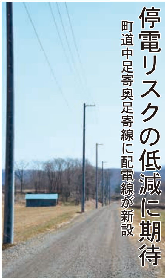
町道中足寄奥足寄線に設置された配電線
