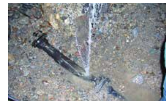
老朽化した水道管の漏水
