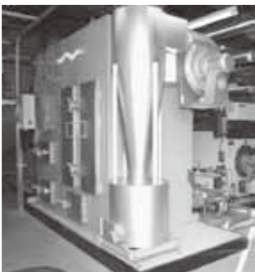
役場庁舎ペレットボイラー
